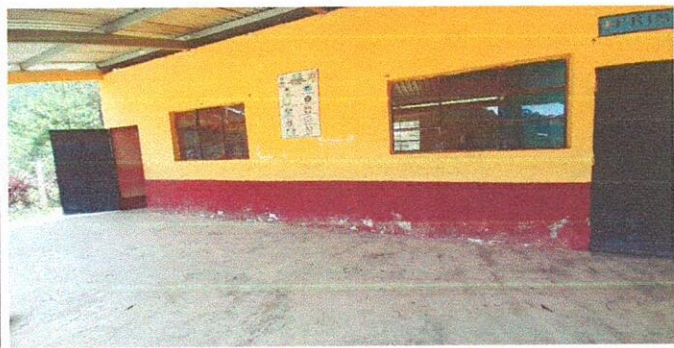
Foto 1: Se observa deterioro en paredes, desprendimiento de pintura, estructura de ventanería en mal estado y la falta de instalaciones eléctricas.
