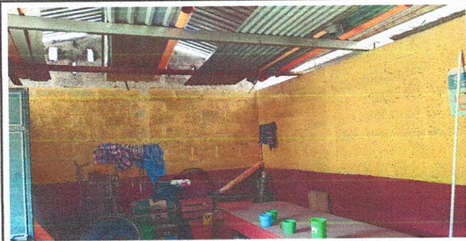
Foto 3: Se observa deterioro en paredes y piso de la cocina del establecimiento provocado por el paso del tiempo y la humedad, se obaserba tambien la falta de instalaciones eléctricas.
